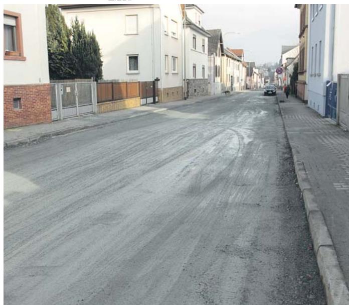
Grauer Schlamm. Ziemlich verärgert sind zurzeit viele Bewohner der Schulstraße über die Baustelle vor ihren Haustüren. Nach den jüngsten Regenfällen verwandelte sich ihre Straße in eine graue Schlammplumpe und der feine Schmutz, den der aktuelle Belag erzeugt, wurde nicht nur bis weit auf die Sulzbacher Straße verteilt, sondern auch in den Häusern und Wohnungen. Bis etwa Mai sollen die Arbeiten in der Straße in Alt-Schwalbach noch andauern. Foto: Bär
