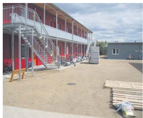
Die Container-Anlage „Im Wehlings“ am Ortseingang von Schwalbach wird ähnlich aussehen wie die Einrichtungen in der Frankfurter Straße in Hofheim oder am Westring. Foto: MTK
