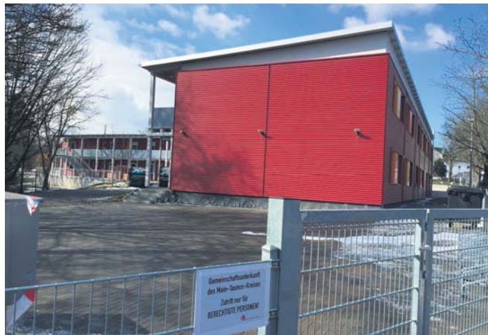
Geschlossen ist das Tor der Flüchtlingsunterkunft „Am Erlenborn“. Wegen Feuchtigkeitsschäden und Schimmelbildung mussten im Februar alle 71 Bewohner ausziehen. Foto: Leyendecker
