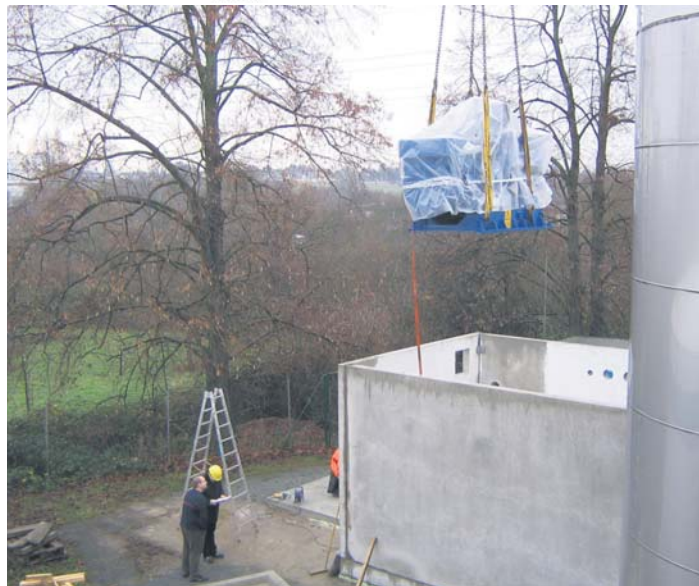
Im Dezember 2010 wurde das Vorgänger-Aggregat eingesetzt. Nun erhält das Blockheizkraftwerk ein neues Aggregat, das Strom und Wärme für die Limesstadt erzeugt. Archivfoto: innogy
