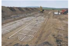
Die IG Fernwärme möchte prüfen, ob ein Erdwärmekollektor wie in Bad Nauheim auch für Häuser in Schwalbach eine Alternative sein könnte.
