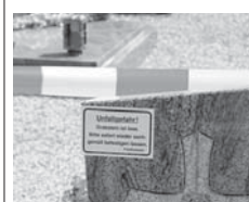
Mit Aufklebern wird auf Grabsteine hingewiesen, die nicht mehr sicher stehen. Foto: Archiv
