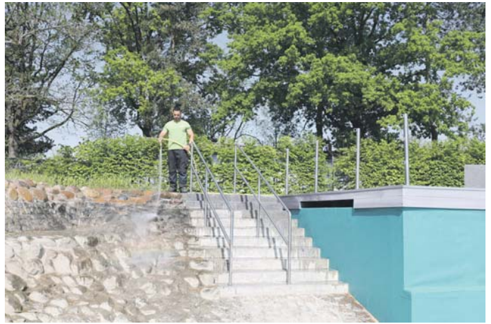
Der stellvertretende Badleiter Bogdan Costache bereitet das Schwimmerbecken für den Start der Naturbadesaison vor, die am Pfingstsonntag, 18. Mai, beginnen soll. Foto: mag
