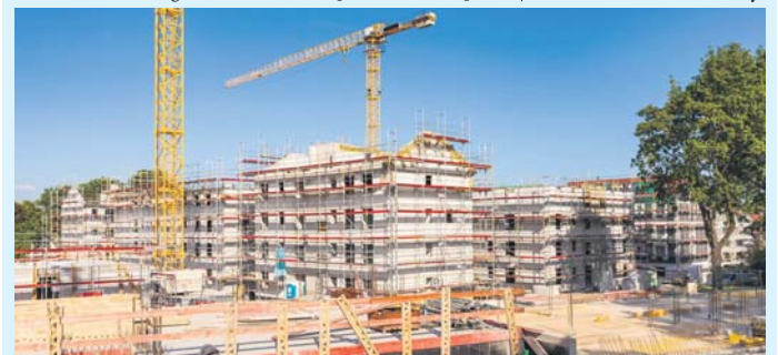
Beim Erwerb von Wohneigentum über einen Bauträger ist der Kunde kein Bauherr, sondern Käufer. Das kann Vor- und Nachteile mit sich bringen. Foto: djd/Dieterich
